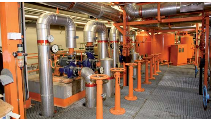
Die Kühl- und Heizräume sind das technische Herzstück.
